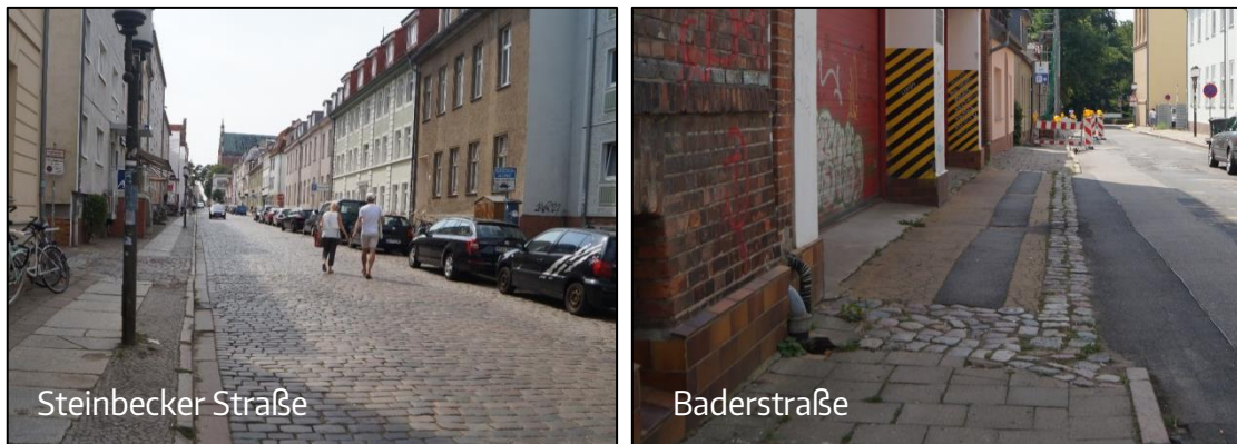
Abb. 2 Oberflächendefizite im Straßennetz mit Verkehrsaufkommen > 3 Mio. Kfz/a
